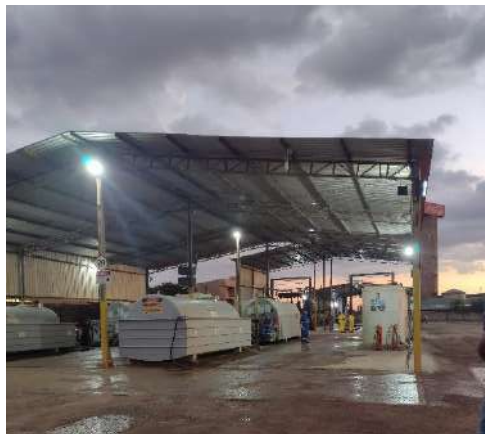
FIGURA 13 - ÁREA DE ABASTECIMENTO A DIESEL E ARLA FOTO: AUTORIA PRÓPRIA
